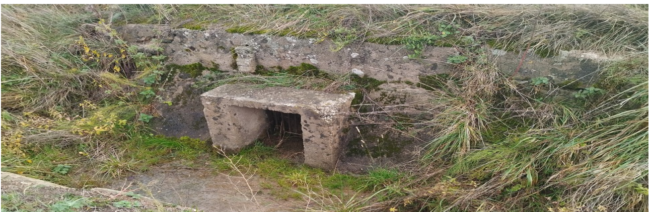
Photo fournie JB MANGIN. Sorties des drains, octobre 2023
